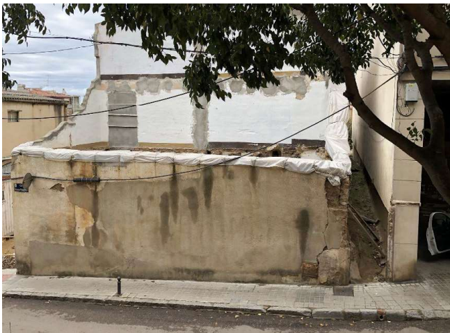
Imatge 7: Vista de l'edificació número 36, que es troba parcialment enderrocada. Les parets de càrrega de tàpia s'han protegit amb lones de plàstic o esquerdejat de morter per evitar-ne la degradació.
